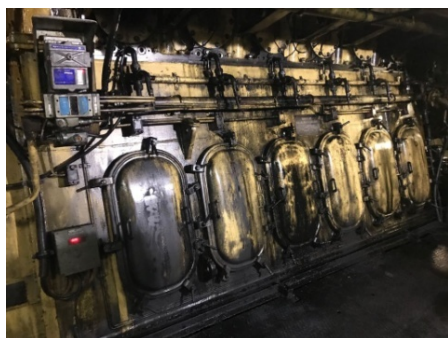
Рис. 3. Последствия пожара в подпоршневом пространстве
