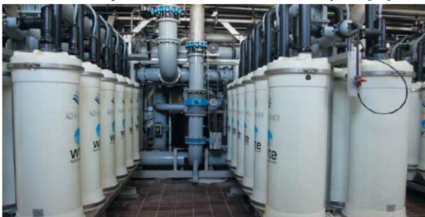
Рис. 6. Зал мембранного фильтрования Юго-Западной станции водоподготовки г. Москвы
