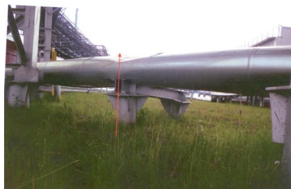
Рис. 2. Эстакада пожарного водовода
