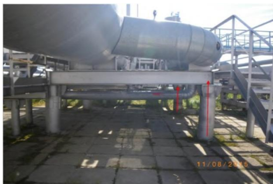
Рис. 1. Площадка кранов выходного коллектора ГПА
